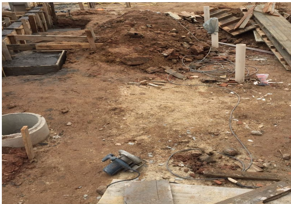
Figura 4 - Fios soltos no chão do canteiro da obra C.
