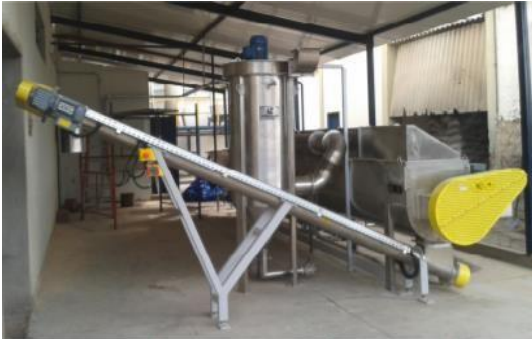
Figura 03 – lavador de gases e transportador helicoidal de lodo seco.
